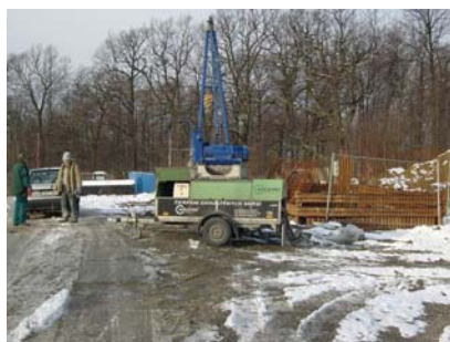
Příprava čerpadla KTX 125 pro zaplňování
